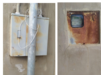
Figura 2. Caixa de medição disjuntor voltado para o interior do imóvel em Miranda-MS
