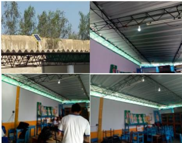
Figura Nº 1 - Instalacion del Sistema Fotovoltaico al Laboratorio de Ciencias de la I.E. 81583 "La Merced"
