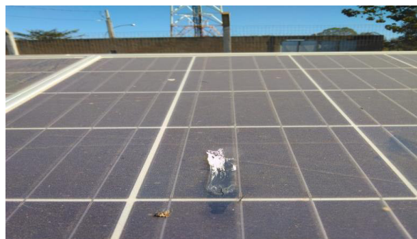
Figura 1. Efeito da sujeira no painel fotovoltaico.
