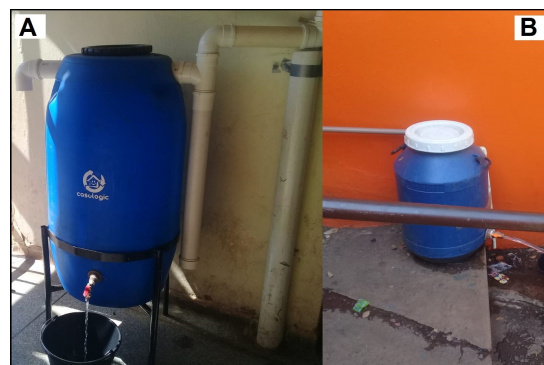
Figura 1. Composição para apresentação das cisternas instaladas na Escola Municipal Domingos Gonçalves Gomes: A) Cisterna de 240 litros e B) Cisterna de 35 litros.
